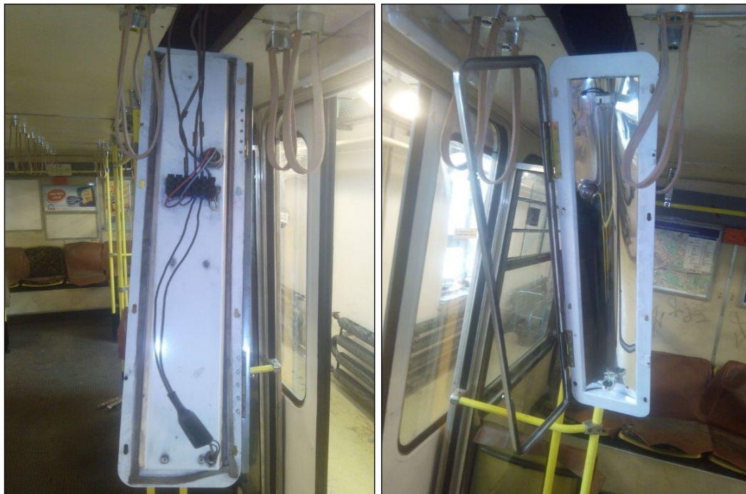
4.4. ábra: Meglévő fénycsöves világítótest szétszerelt állapotban
